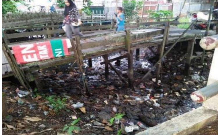
Gambar 3. Kondisi sampah yang menumpuk di bawah jembatan
